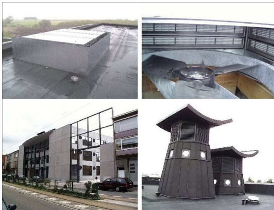
Figur 4.2. Øverst: Afkasthætte med åbning i toppen, der sikrer undertryk for alle vindretninger (B&O kontorbygning, Struer). Aksialventilator med stor diameter er integreret i afkastet. Nederst: Kontorbygning i Belgien med afkastskorsten med åbning i alle retninger, således at undertryk altid kan sikres.
