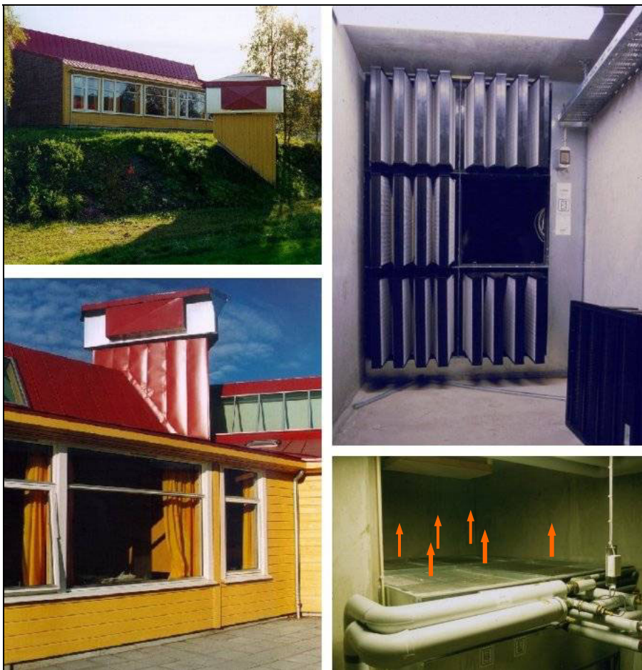
Figur 4.6. Til venstre: Indtag og afkast placeret med så stor højdeforskel som muligt. Indtag og afkast har åbning i forskellig retning og styres således, at åbning i indtag altid er i vindsiden og afkast i læsiden. Til højre: Stort filterareal resulterer i meget lavt tryktab. Varmeflade med lavt tryktab er placeret vandret for at sikre jævn gennemstrømning af luft. (Grong skole, Norge).
