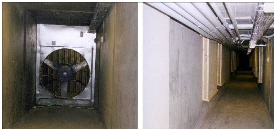
Figur 4.5. Eksempel på indtagskanal med aksialventilator og fordelingskanal under bygning. Kanalen har en dimension, der sikrer let rengøring. Ved hver afgrening er der monteret en "lyddæmper" for at forhindre lydtransmission mellem rum. (Grong Skole, Norge).
