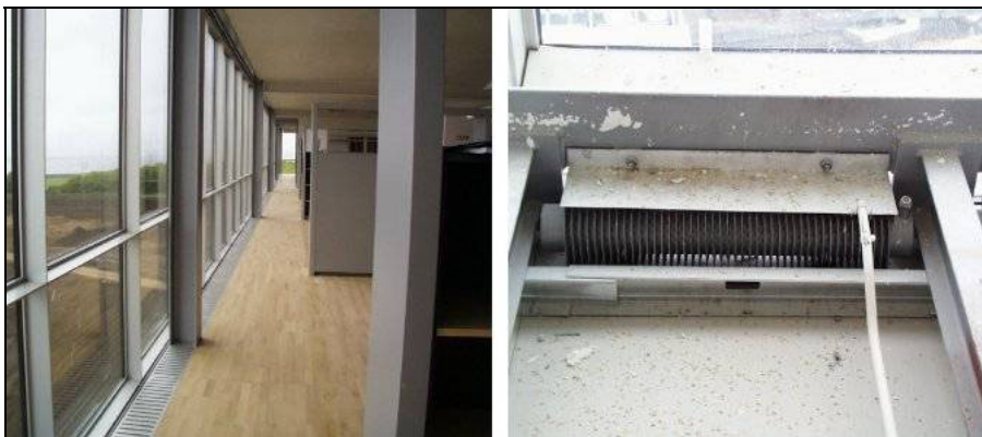
Figur 4.3. Indtagsåbning i facade med forvarmning og lufttilførsel ved gulvniveau for tilførsel af luft efter fortrængningsprincippet (B&O bygning, Struer).
